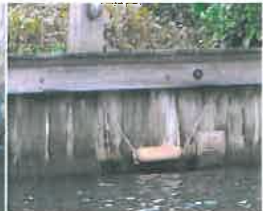
Plaatselijk houtrot in eindstadium,
